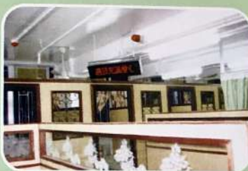
▲ 配有電子呼喚系統
